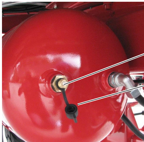
Illustration 54 : Prise de pression pour manomètre sur le réservoir d'air comprimé
